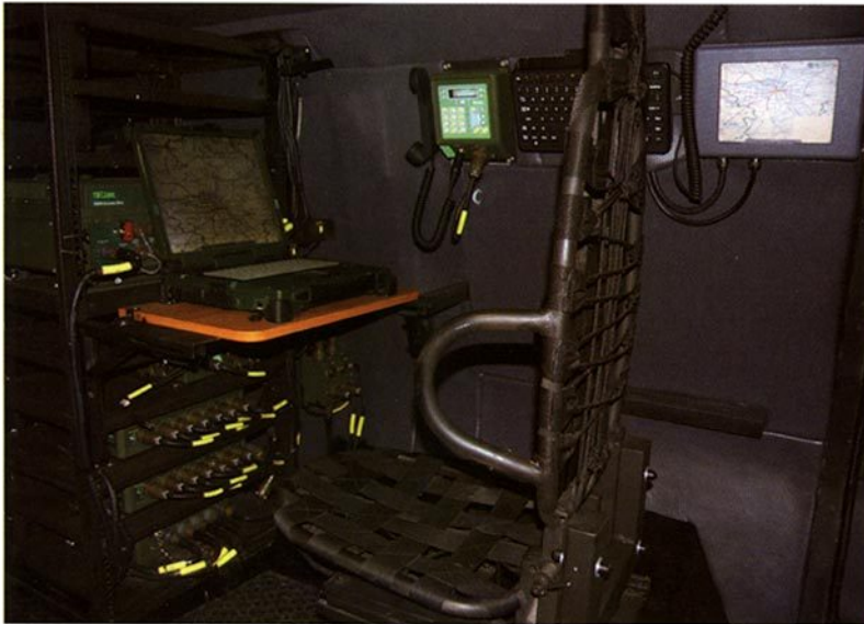
Stojak urządzeń teleinformatycznych z integratorem WAN Acces Box oraz stanowisko pracy osoby funkcyjnej.
